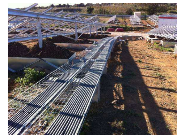
Photo 46 : Vue sur des câbles et leurs supports
